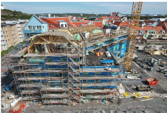
Kv. Hercules norra hus, sett från väster, med samtliga våningar uppe inklusive tak, augusti 2024
